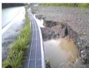
溢れ出た水で削りとられた路面
