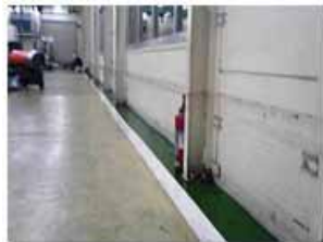
水位の後ろが残る工場のカベ
